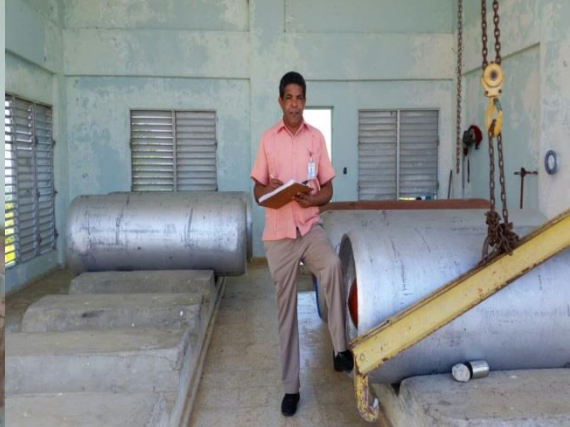
2-Inv/Sulfato y Cloro-gas
