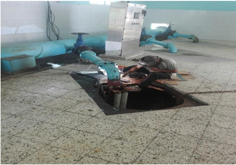
Avería Est.de Bombeo Malecón
