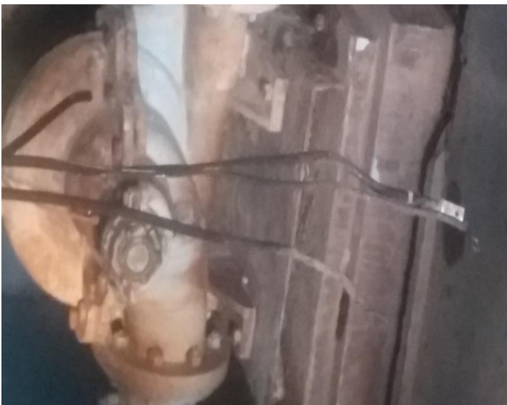
Est. de Bombeo Zona Media
