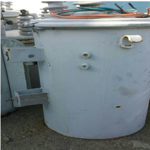
3-Transformadores trasladados de Luperón a Playa Oeste
